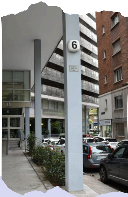
Número de portal ubicado demasiado alto
